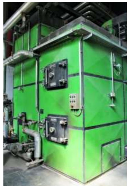
Abb. 14: Kessel der Fernwärme Zell am Moos (KEM Mondseeland 2021)
