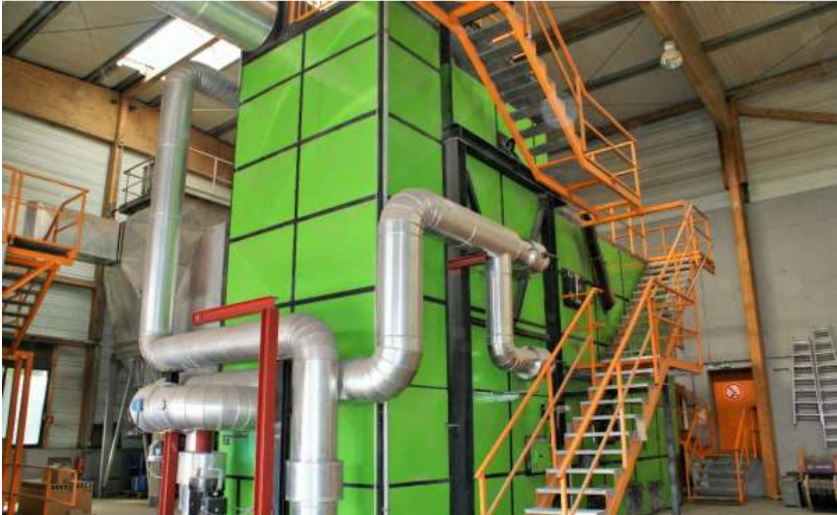
Abb. 13: Kessel der HW Mondsee (Quelle: KELAG WÄRME GMBH 2016).
